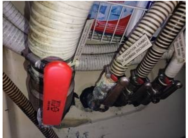
Figura 6: wc poppa- scarico lavello deteriorato
